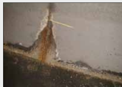
Utæt pakgarnssamling i 60 år gamle Ø 1000 mm rør. Kan håndrenoveres. Betonen er upåvirket.
