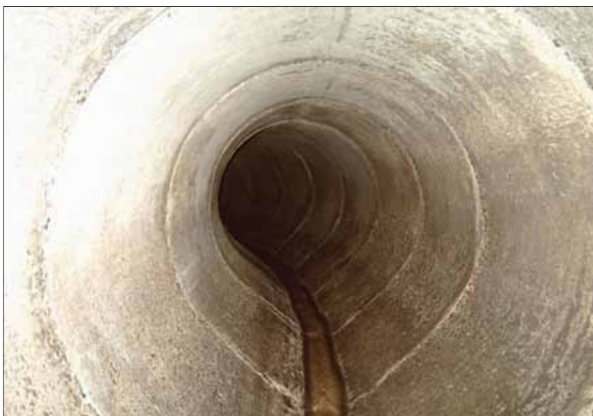
Ø 1000 mm spidsbundsør fra 1950, spildevandsledning, Århus kommune
