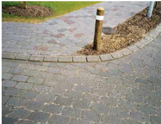
I denne belægning har der været gravet op for at reparere telekabler.
