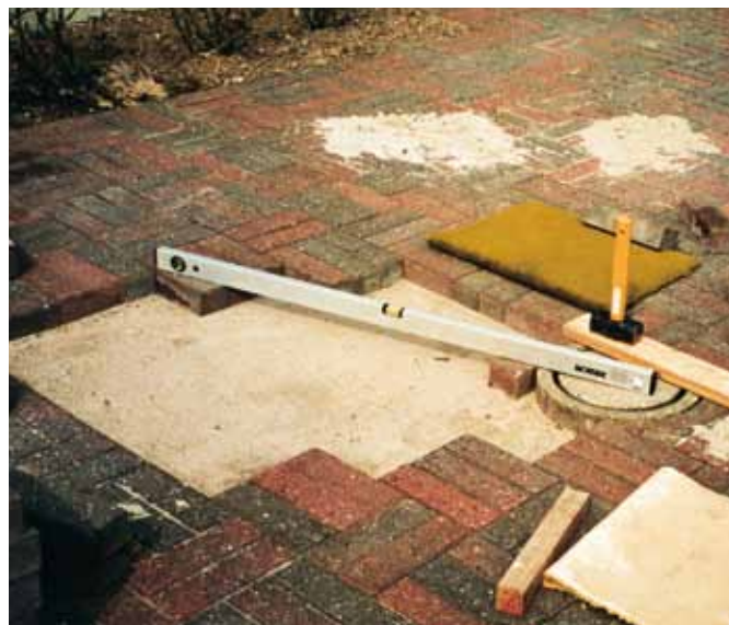
Ved brønddæksler og lignende opstår der ofte lunger pga. for dårlig komprimering eller manglende overhøjde ved lægningen. Opretningen udføres dog let.
